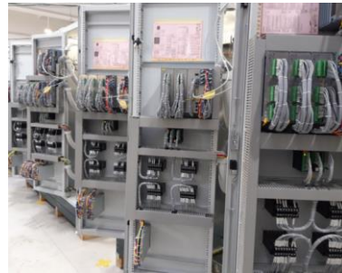
Priprema ormara za Ganu
