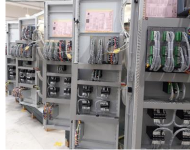
Priprema ormara za Ganu
